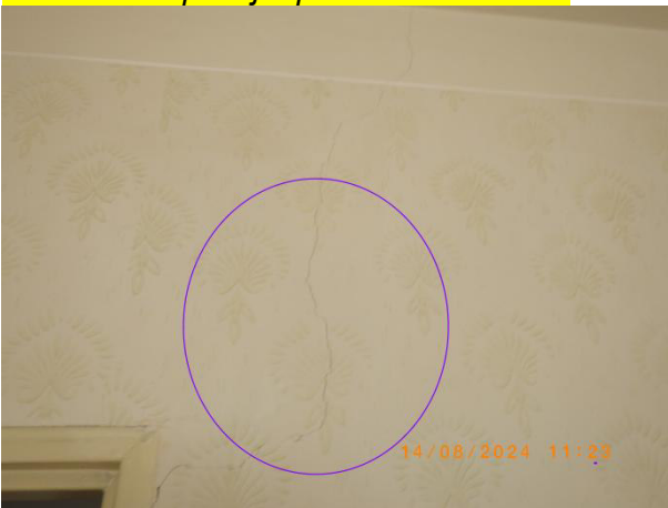
foto 56 2.04 pokoj 2 trhlina příčka
