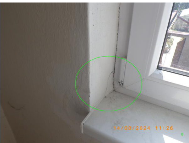
foto 58 2.04 pokoj 2 poškození povrchu
