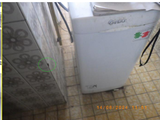
foto 59 2.05 koupelna poškození obkladu
