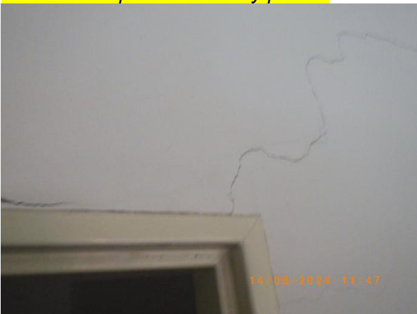
foto 52 2.03 pokoj 1 trhliny přička
