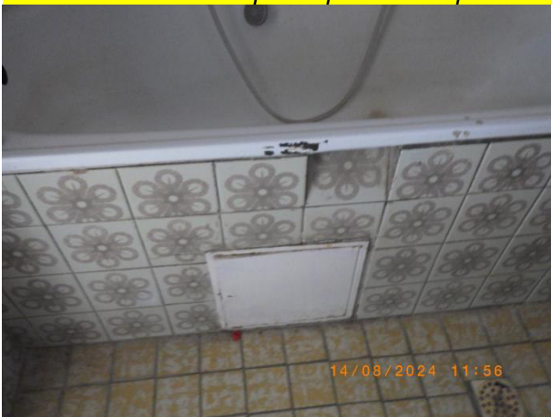
foto 62 2.05 koupelna poškození obkladu vany
