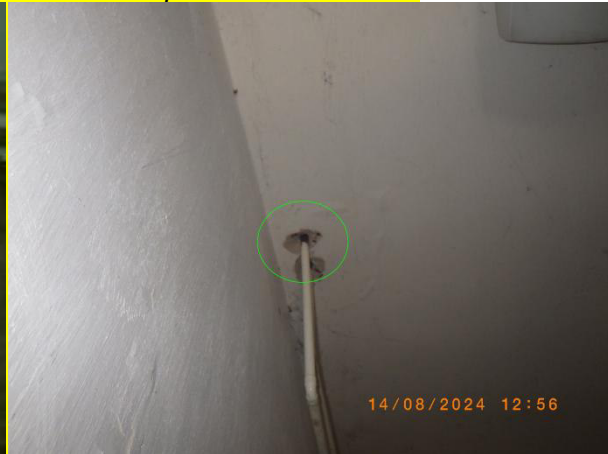
foto 30 1.08 spíž koroze potrubí
