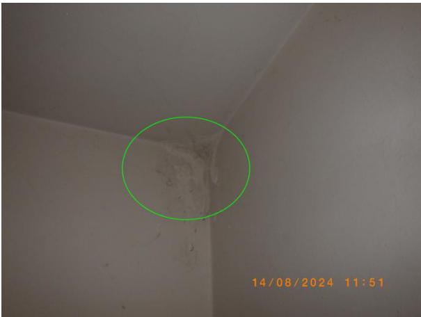
foto 60 + 61 2.05 koupelna poškození povrchu
