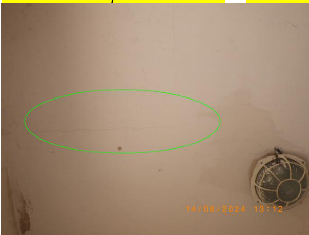
foto 33 +34 1.09 sklep poškození stropu i stěn od trhlin
