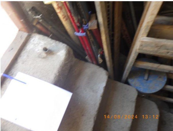
foto 31 1.09 sklep schází zábradlí
