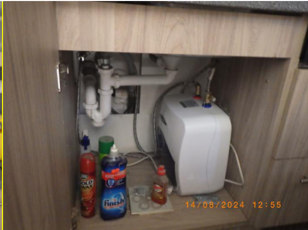
foto 20 1.08 kuchyň ohřivač vody Ariston
