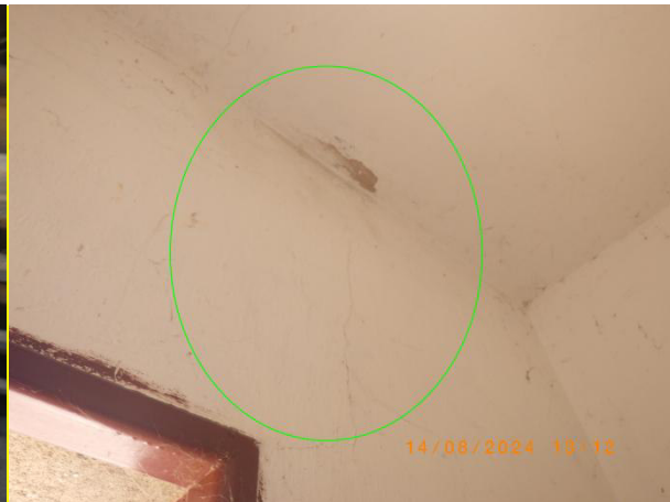
foto 32 1.09 sklep poškození povrchů od trhlin
