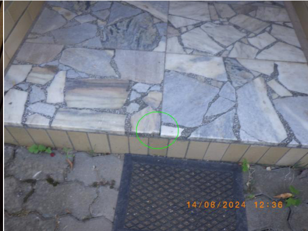
foto 02 1.01 poškozený obklad schodiště
