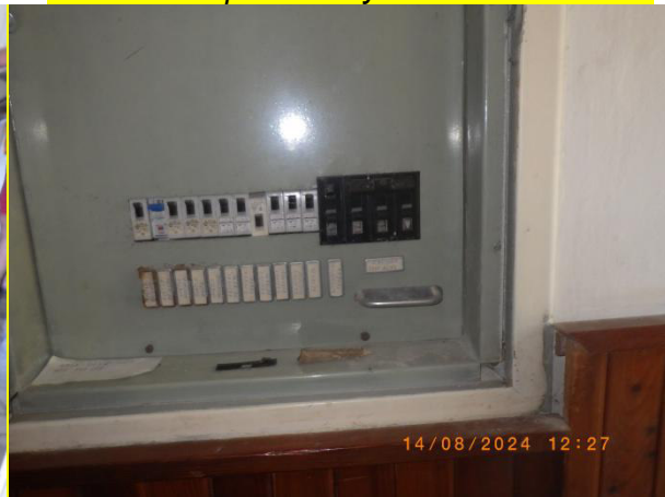
foto 04 1.02 zádveř původní elektro instalace
