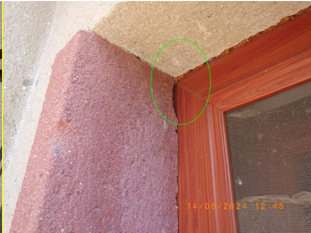
foto 80 nedostatečně utěsněné styčné spáry
