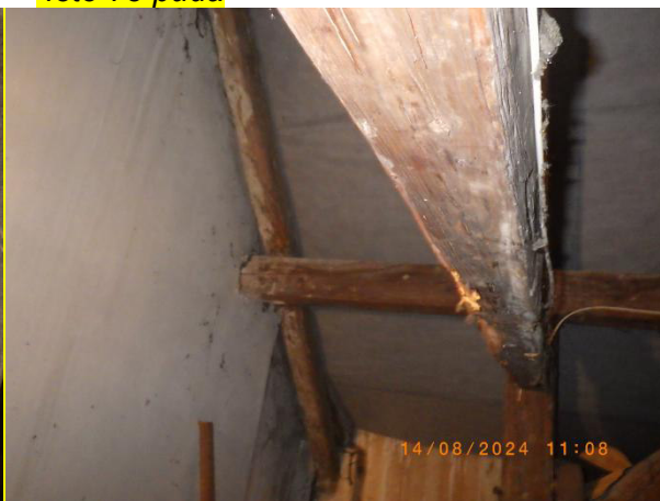
foto 75 poškození od dřevokazného hmyzu
