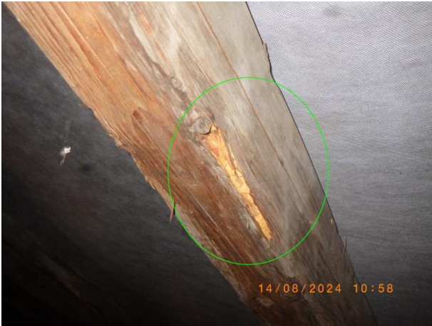
foto 76 poškození od dřevokazného hmyzu
