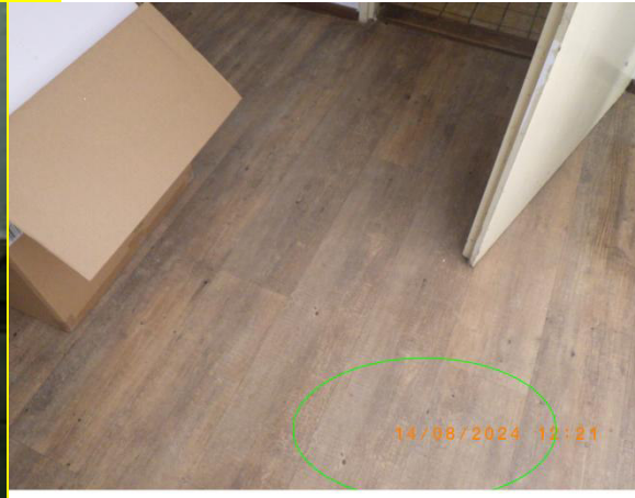
foto 18 1.08 kuchyň poškození podlahy
