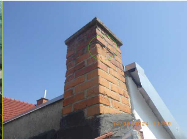
foto 67 2.07 poškozené zdivo komína
