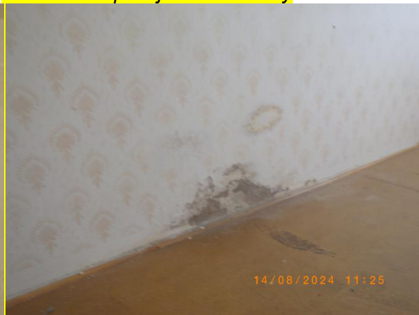
foto 57 2.04 pokoj 2 poškozený povrch omítky
