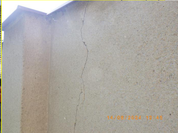
foto 82 poškození od trhlín plotová zeď
