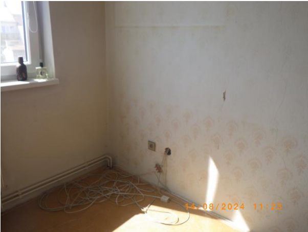
foto 54 2.04 pokoj 2 poškození omítek
