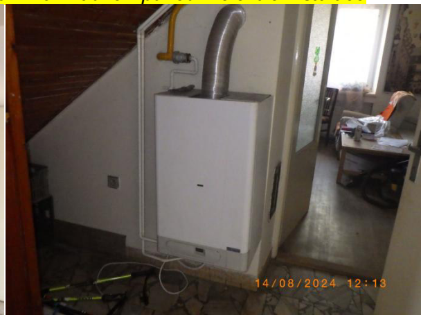
foto 06 1.03 schodiště plynový kotel
