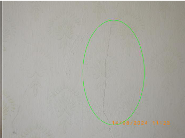
foto 55 2.04 pokoj 2 detail trhliny
